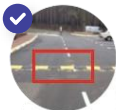
✓ Нарушение целостности лежачего полицейского
