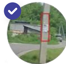
✓ Грязная опора освещения
