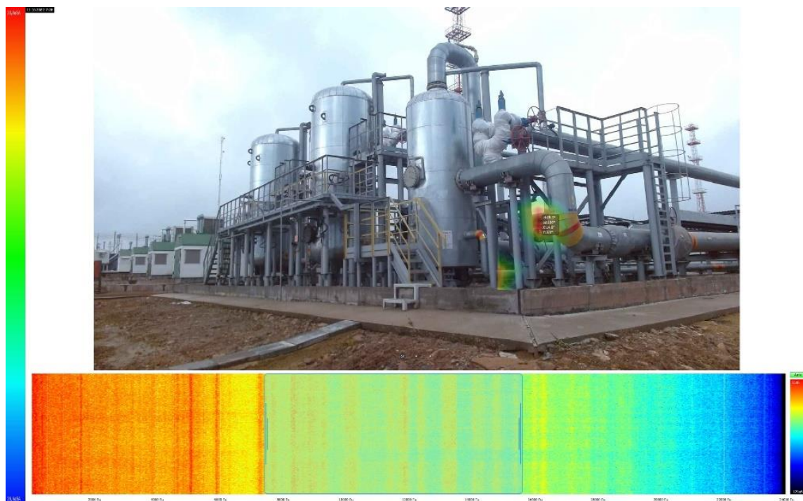
Утечка в структуре трубопровода
